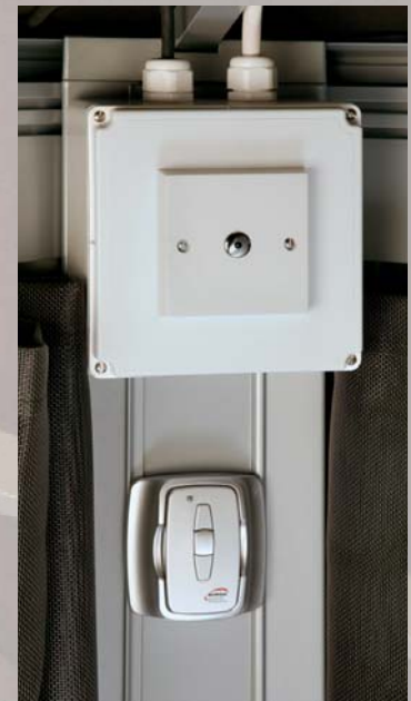
Beleuchtungsschaltkasten mit eingebautem Dimmerschalter
